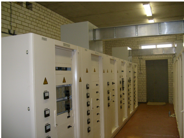
Рис.5 Присоединение горизонтальное к шкафам РУНН не типовыми присоединительными секциями. Аэробус, г. Воронеж.
